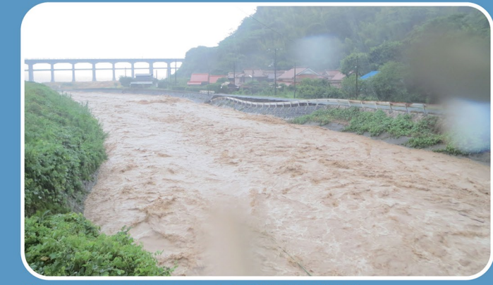
増水により破壊された白須川護岸(惣郷)
