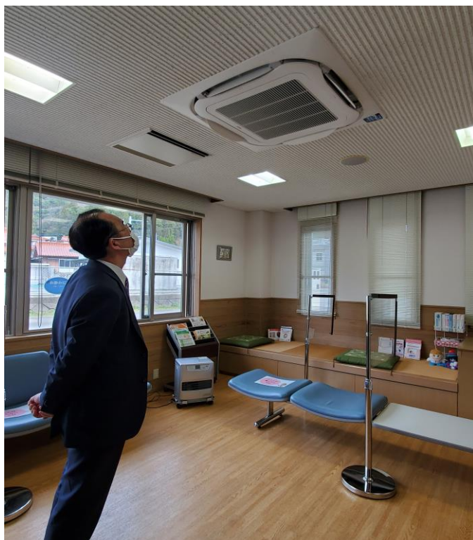
待合室空調機
