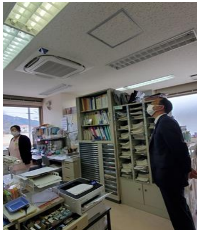
事務室空調機
