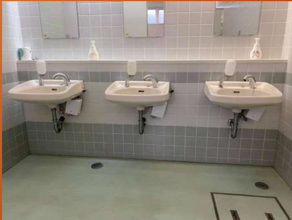
《のうそんセンターの手洗い場自動水洗化》
