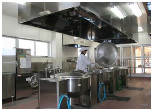
オール電化、ドライ方式を導入 している阿武町給食センター
